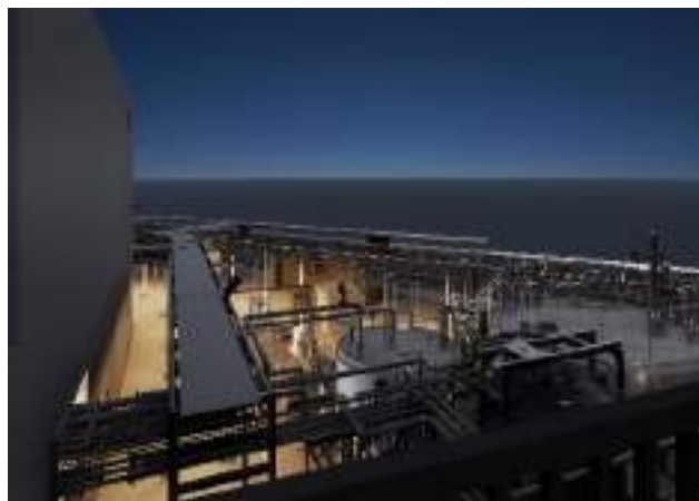
バイオガスプラント
