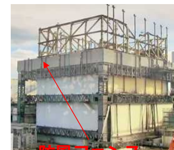
防風フェンス
