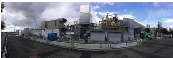
水素コージェネレーションシステムのプラント
