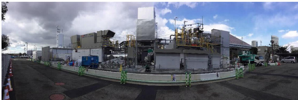
図1 水素コジェネレーションシステムのプラント
