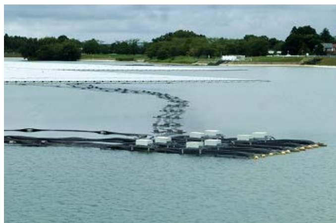
太陽光パネルから伸びる電力ケーブル
