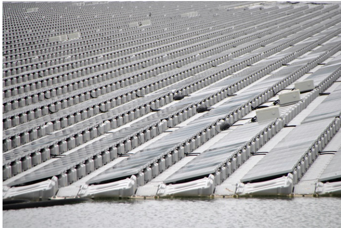
太陽光パネルの設置状況
