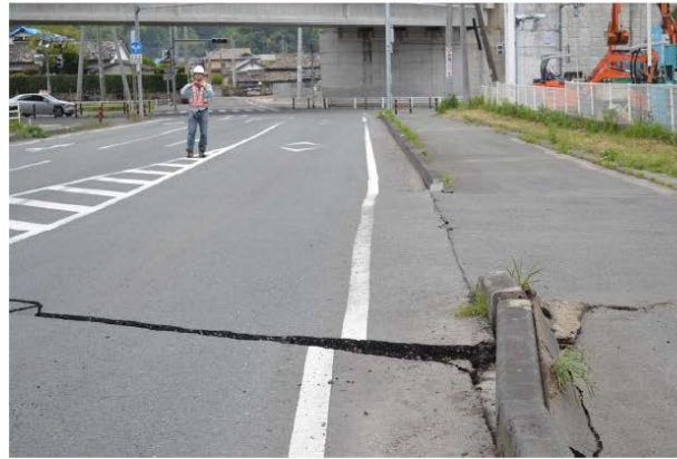
地点1（土山） 右横ずれ 20-30 cm 14日の地震後に多少の変位があった。目立った段差になったのは、16日未明のM7.3の地震後。
